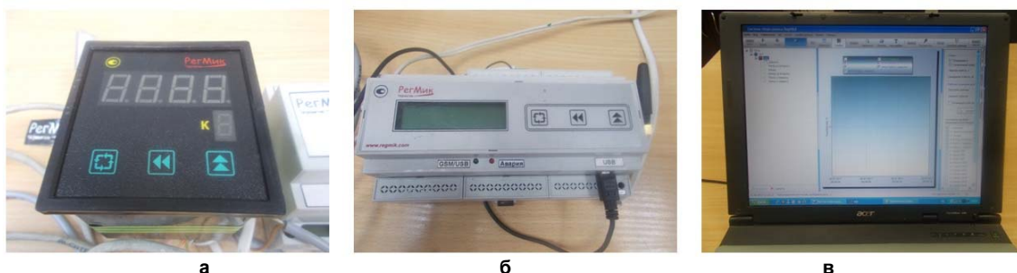
Рис. 5. Основне вимірювальне обладнання, яке використовувалося для проведення експерименту на геотермальній теплонасосній системі:
