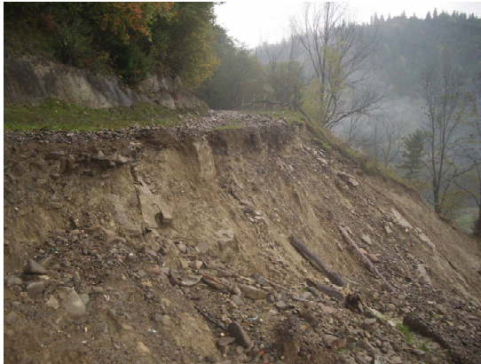
Рис. 3. Стінка відриву сучасного осуву у верхній частині осувонебезпечної ділянки та наслідки руйнування дороги місцевого значення
